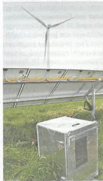
Die Solaranlage versorgt die Pumpe für die Unterflurbewässerung mit Strom.
